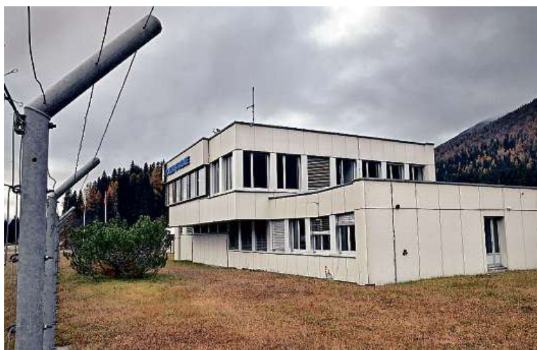
Sanierung notwendig: Der Zahn der Zeit nagt unübersehbar am kantonalen Verkehrsstützpunkt in San Bernardino. (JFP)
